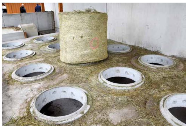
Die Solarwärmeableitung vom Dach wird im Keller gespeichert und für die Trocknung von Heu und Hackschnitzel verwendet.
